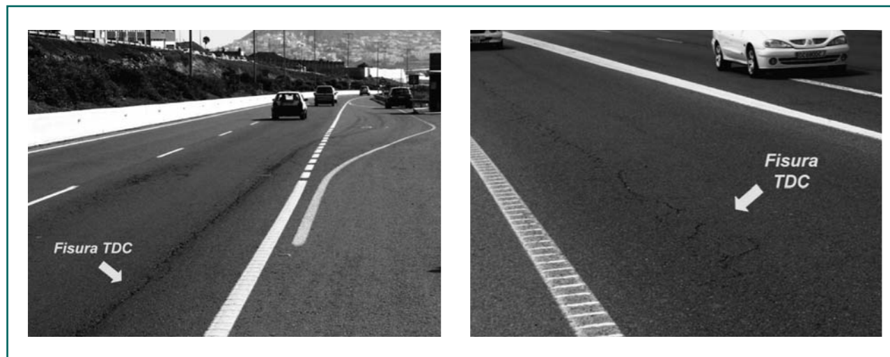
Figura 24.- Fisuras longitudinales en el interior de las bandas de rodadura con múltiples grietas interconectadas y aspecto de fisuración por fatiga. a) GC-2. PK 24+000; b) GC-1, Las Palmas de Gran Canaria, PK 5+500 (2009).
