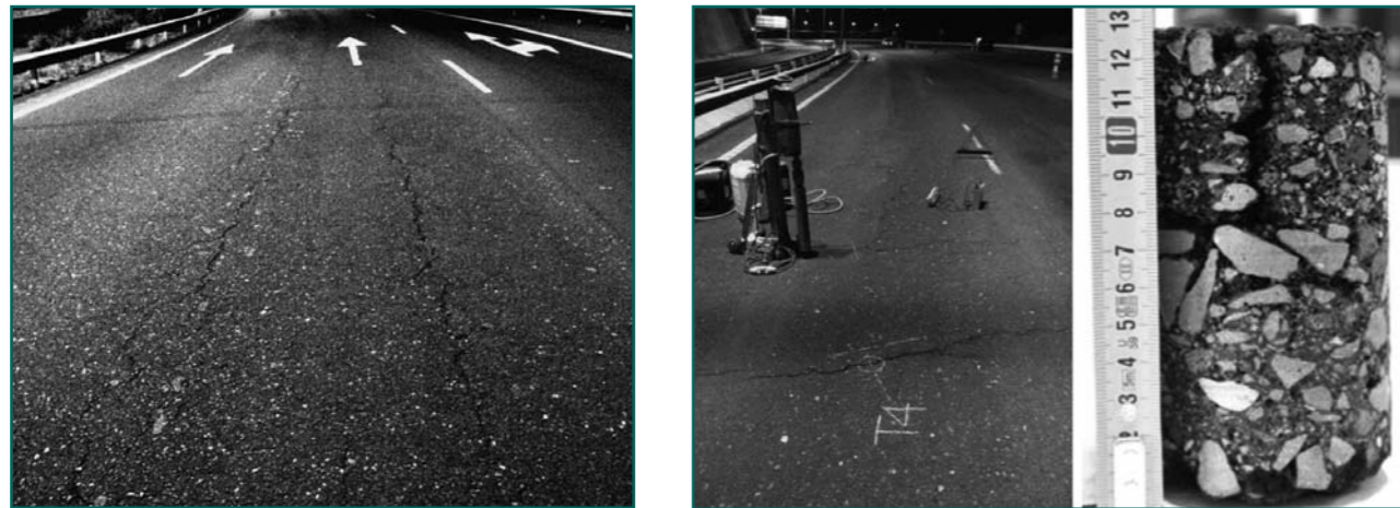
Figura 2.- Ejemplos de fisuras de tipo TDC en la GC-3 y testigo extraído (Las Palmas de Gran Canaria, 2010).
